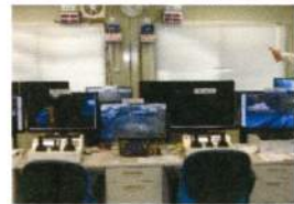
地面を掘り下げる遠隔ドリルの操作室。
